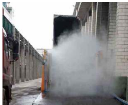
汽车卸料口喷雾抑尘
